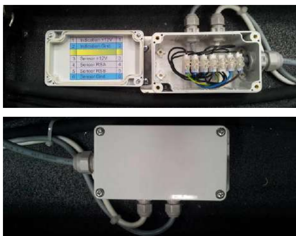
Рис. 3. Ревизионная клеммная коробка блокиратора с клеммной колодкой TX1. Blocker connection block и кабельными гермовводами.
